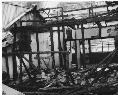
▲ 火災により焼けた建物
