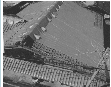
▲ 台風飛ばされた屋根
