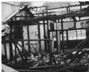
▲ 火災により焼けた建物
