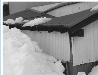
▲ 雪の重みでつぶれた屋根
