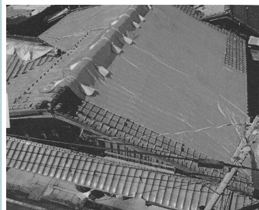
▲ 台風飛ばされた屋根
