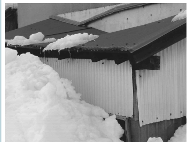
▲ 雪の重みでつぶれた屋根
