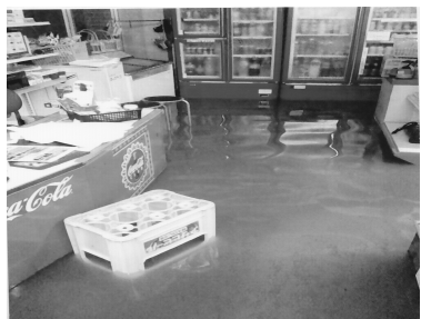
▲ 豪雨により浸水した店内
