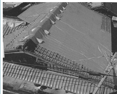
▲ 台風飛ばされた屋根
