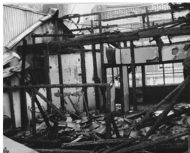
▲ 火災により焼けた建物
