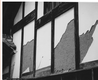
▲ 強風により剥がれた壁
