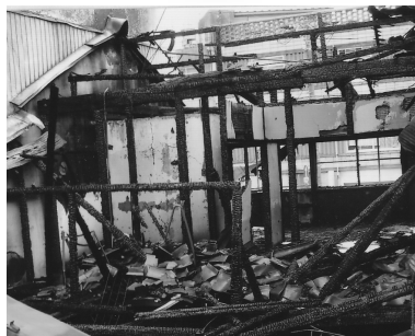
▲ 火災により焼けた建物
