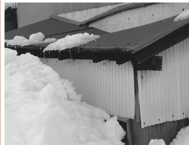
▲ 雪の重みでつぶれた屋根
